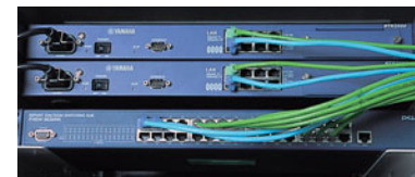
マシンルームに設置されているヤマハルーター-RTX2000(上)およびRT56v(右)
